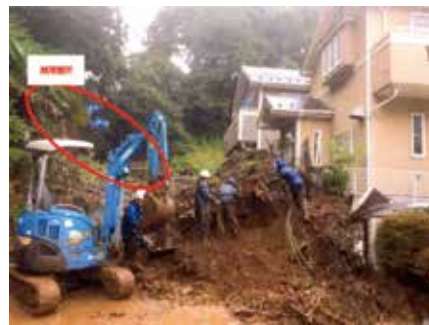
大塚ゆざわ公園・陽光台緑地の崩落現場
