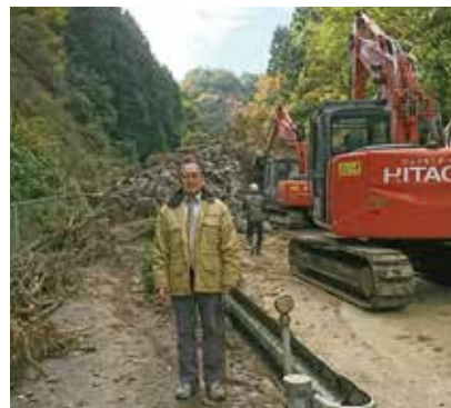
3か月通行止めとなった戸沢峠崩落現場
