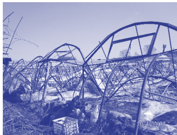
雪でつぶれたビニールハウス(3月8日、小比企町)
